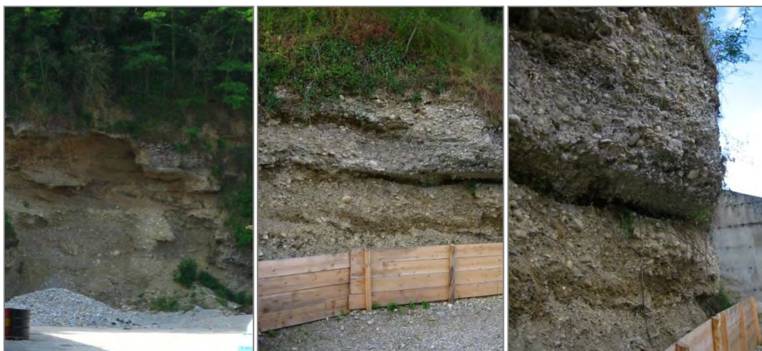
Pied de talus sujet à glissement en aval du projet
